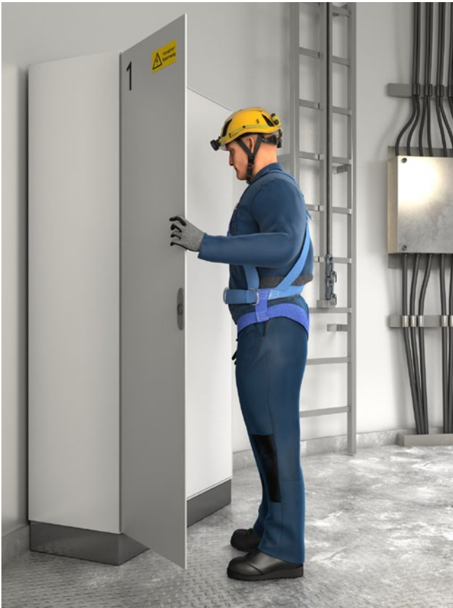
Abb. A12-1 Schaltschrank
